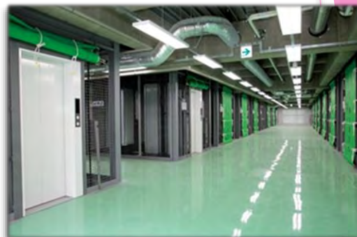
▲ エレベーター実習場
